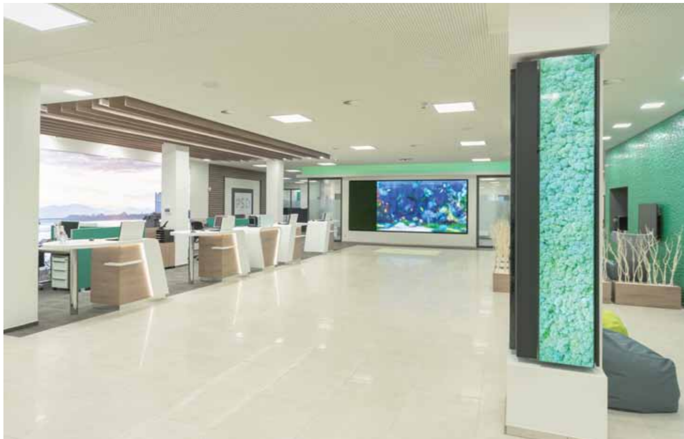
▲ Neue Medientechnik mit großen Videowalls und Stretch-Monitoren wurde im Eingangsbereich und Foyer installiert
